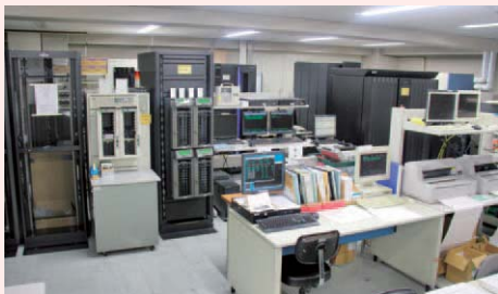
システム部内電算室
